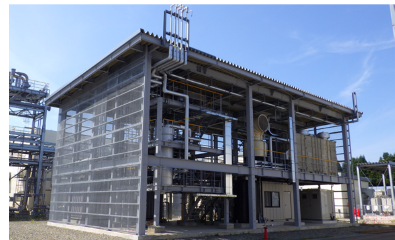
CO 2 -メタネーション試験設備
